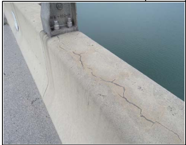
내 용 S11 방호벽 균열보수 상태양호
