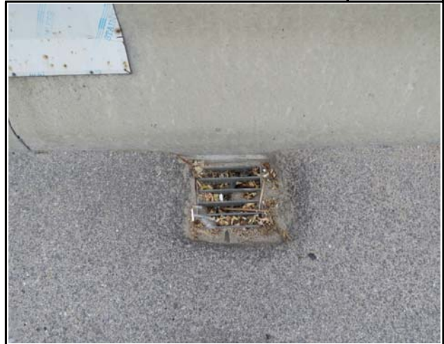
내 용 S6 배수구 이물질 퇴적
