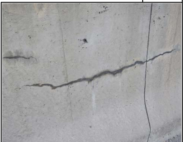
내 용 S15 방호벽 균열부 백태(CW=0.2)
