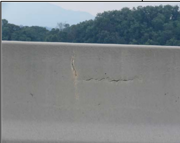
내 용 S13 중앙분리대 균열부 백태(CW=0.2)
