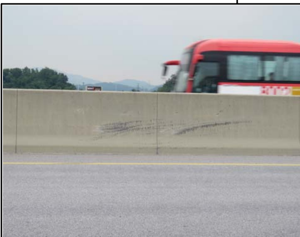
내 용 S14 중앙분리대 사고흔적
