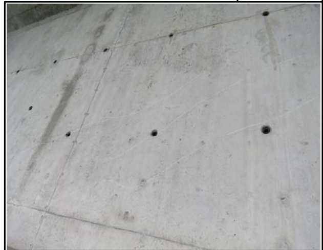
내 용 S10 우측벽체 균열(CW=0.2) 4EA
