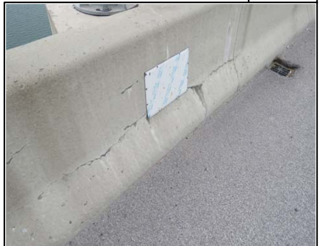
내 용 S13 방호벽 균열(CW=0.2)
