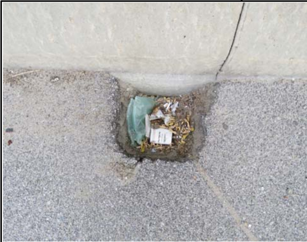
내 용 S5 배수구 이물질 퇴적
