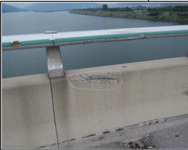
내 용 S10 방호벽 파손(A=0.3X0.7)
