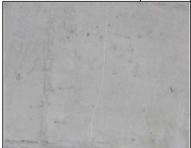
내 용 S9 하면 균열(CW=0.2)
